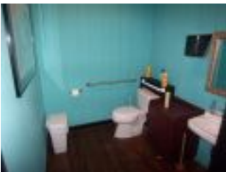
ADA compliant bath
